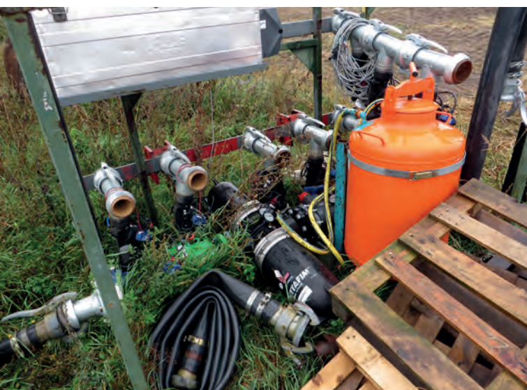
Am Feldrand steht die zentrale Wasser-Verteilstation. Hier kann direkt Dünger in den Wasserstrom eingespeist werden. Foto: Buch
