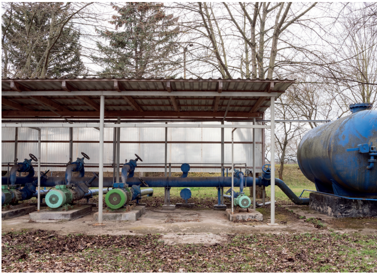
Die vier frequenzgesteuerten Beregnungspumpen drücken bis zu 500 m 3 /h Wasser in das Leitungsnetz des Beregnungssystems.
