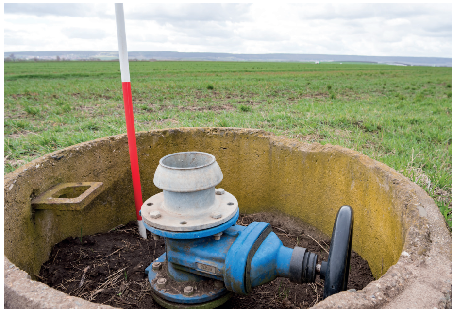
Die Abstände zwischen den Entnahmepunkten für das Wasser aus dem unterirdisch verlegten Leitungsnetz wurden an die neue Beregnungstechnik angepasst.
